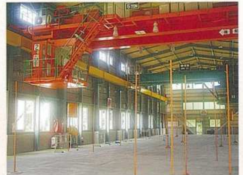
天井式クレーン
