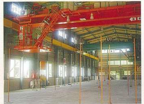
天井式クレーン
